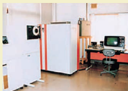
当時の電算室機械室
