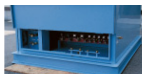
一次側キャブタイヤ取付部
