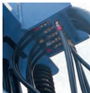
偏心モーメント制御配管部
