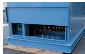
一次側キャブタイヤ取付部
