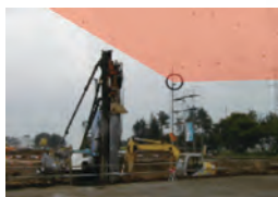
高圧線直下作業／空頭検知
