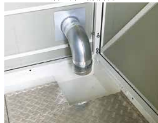
溜め升・防油堤
