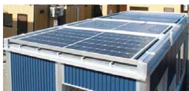
太陽光パネル
