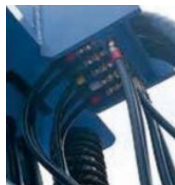
偏心モーメント制御配管部
