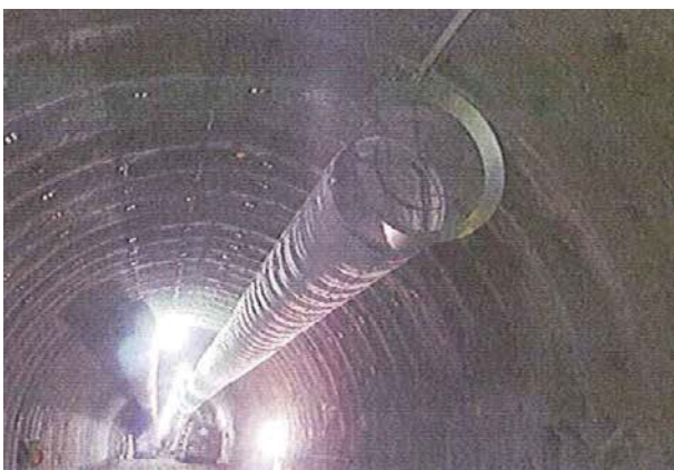
伸縮風管全景
