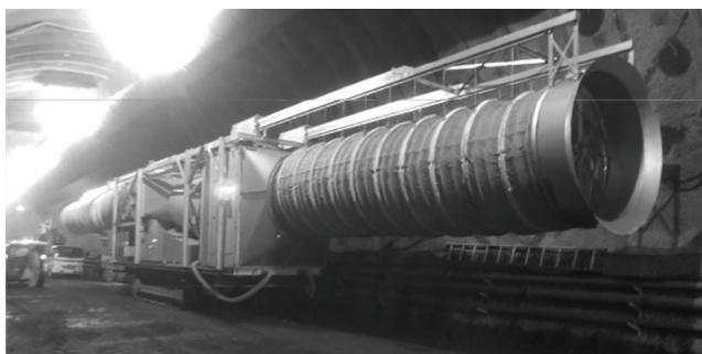
ECステーション (吸込側から見る)
