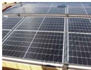
太陽光パネル
