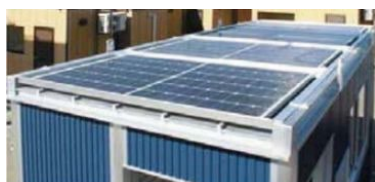
太陽光パネル
