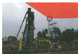
高圧線直下作業/空頭検知
