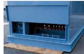
一次側キャブタイヤ取付部
