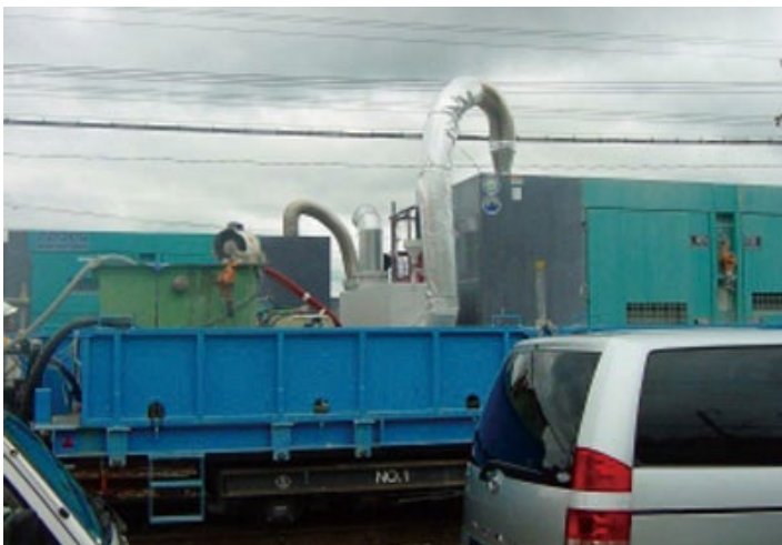
発電機（220kVA）接続例（鉄道トンネル補修のため車両に搭載）
