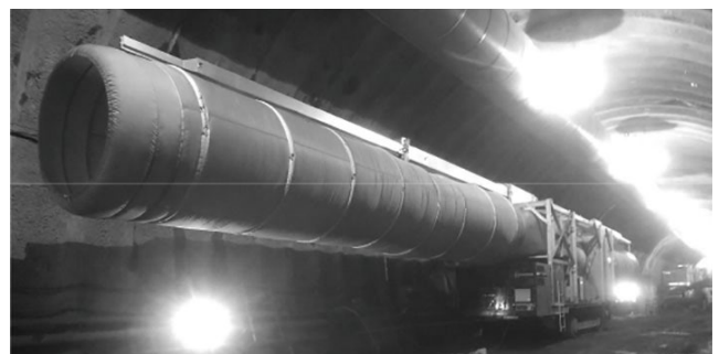
ECステーション (排出側から見る)
