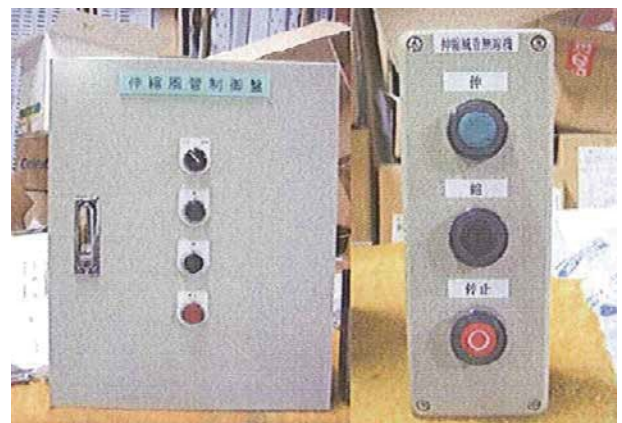
制御盤、リモコンスイッチ
