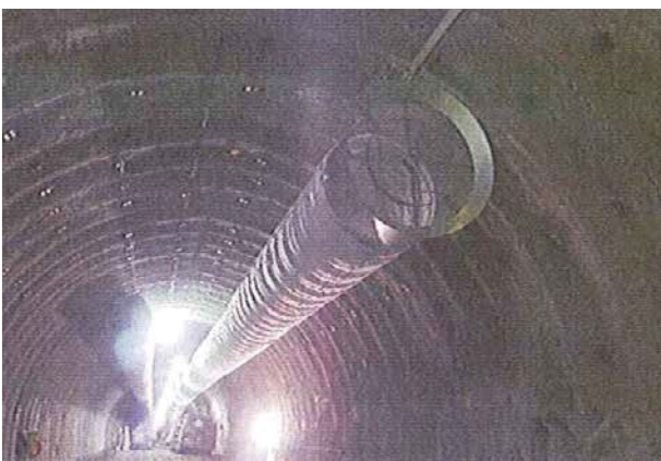
伸縮風管全景
