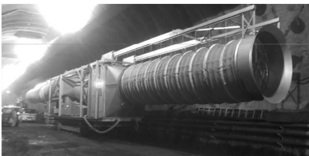
ECステーション (吸込側から見る)
