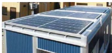
太陽光パネル
