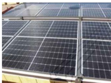
太陽光パネル
