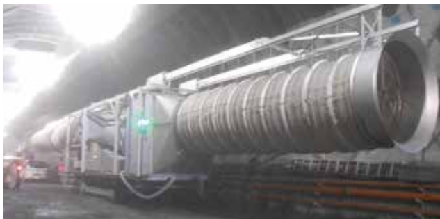
ECステーション (吸込側から見る)
