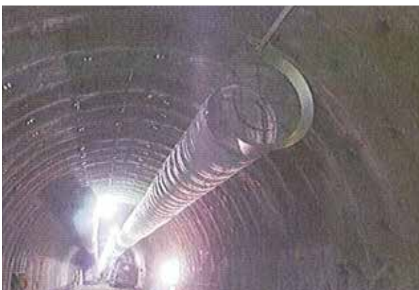
伸縮風管全景
