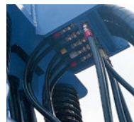
偏心モーメント制御配管部
